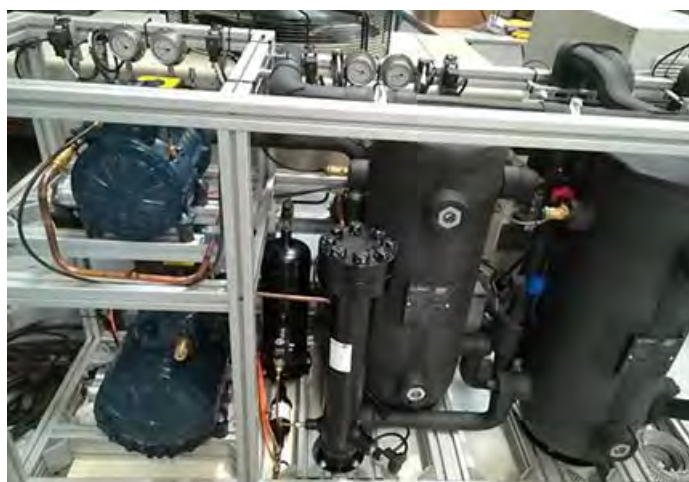
Banc d'essais Centrale Booster Transcritique CO2
